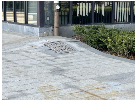
图 4-12 道路铺装不均匀沉降
