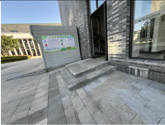
图 4-9 楼梯倾斜严重
