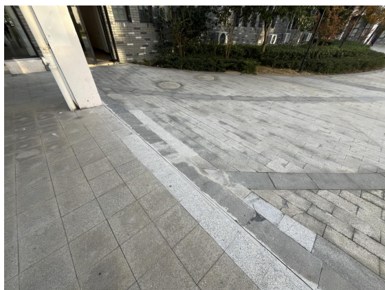
图 4-8 地面不均匀沉降
